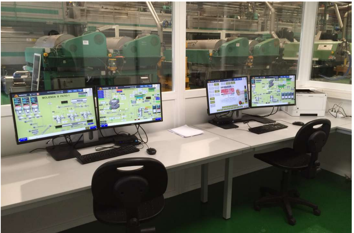
Sala de control de proceso ubicada en Área de Extracción, desde donde se controla el proceso de molturación y extracción del aceite de oliva
