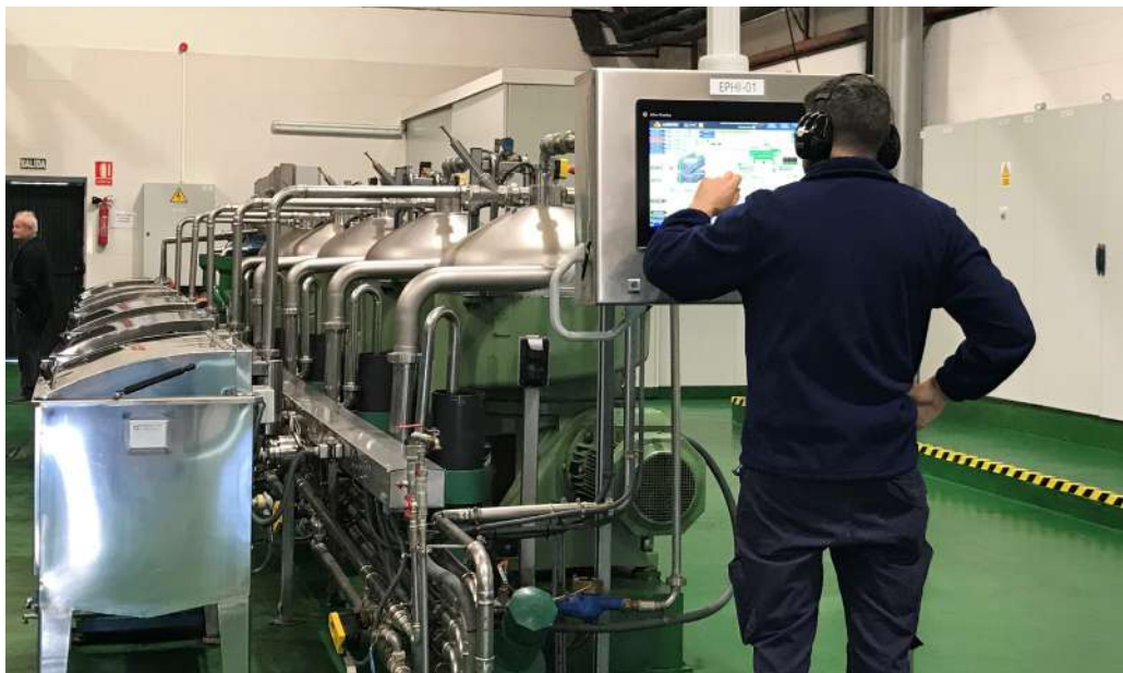
Sistema de operación local en Sala de Extracción contiguo a Centrifugas Verticales, desde donde se mantienen las ventajas de visualización y operación integral que existen en la sala de control, pero a pie de planta
